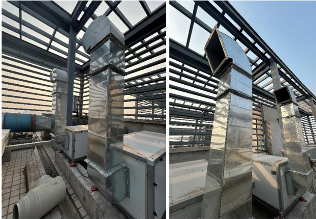
核医学科 2 套排风系统位于屋面的排风口
